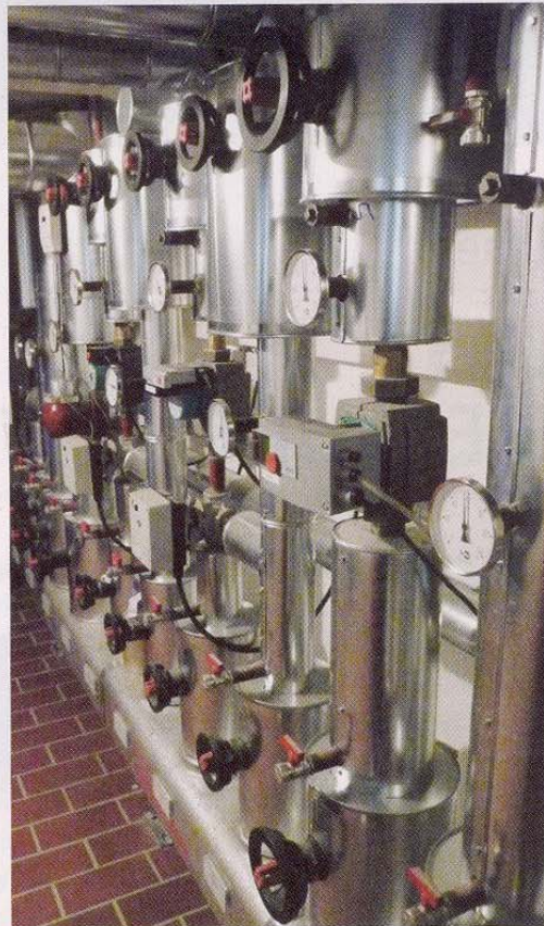
Eine Pflanzenölpumpe (Bild ganz oben) versorgt das BHKW mit Brennstoff; über die Heizungsverteiler (Bild oben) werden zwei Pfarrhäuser, das Pfarramt, das Gemeindehaus sowie der Kindergarten mit Wärme versorgt
